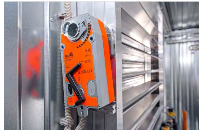
Внутри - автоматические клапаны притока-оттока воздуха с электроприводом Belimo 24/220 В
