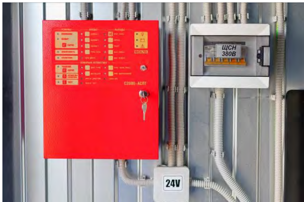
Система пожарной/охранной сигнализации на базе прибора С2000АСПТ и щит собственных нужд контейнера (ЩСН)
