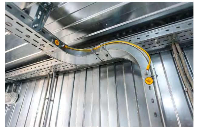
Верхняя разводка кабелей в гофрированных трубах - в подвесных металлических коробах (подвесные системы ДКС, Италия)
