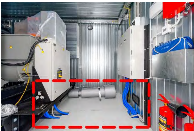
В полу контейнера расположена скрытая магистраль для прокладки силовых кабелей и прочей электроразводки
